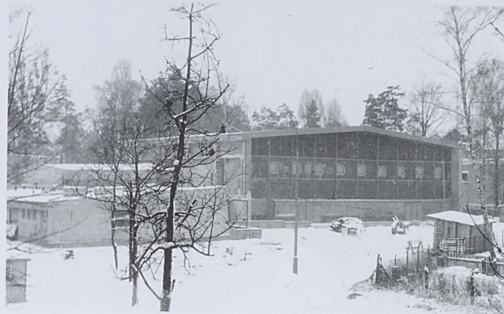
Hala Sportowa w budowie. Początek lat 70-tych. Fot. ze zb. J. Szczypiora.
