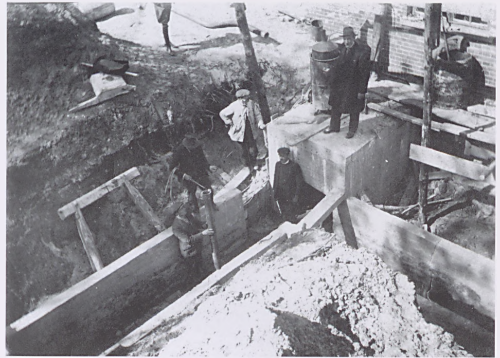
Budowa rurociągów rozprowadzających ogrzewanie. Państwowa Wytwórnia Prochu. Lata dwudzieste. Fot. ze zbiorów Mariana Wiktorowskiego
