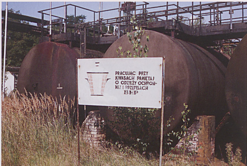
Zbiorniki magazynowe na kwasy. Foto ze zbiorów Jarosława Szczypiora.
