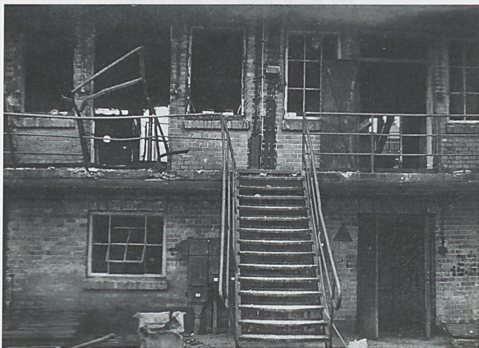
Zakład (Wydział) „PA” ZTS „Pronit”. Budynek produkcyjny po wybuchu. Lata siedemdziesiąte. Foto ze zbiorów Jarosława Szczypiora.
